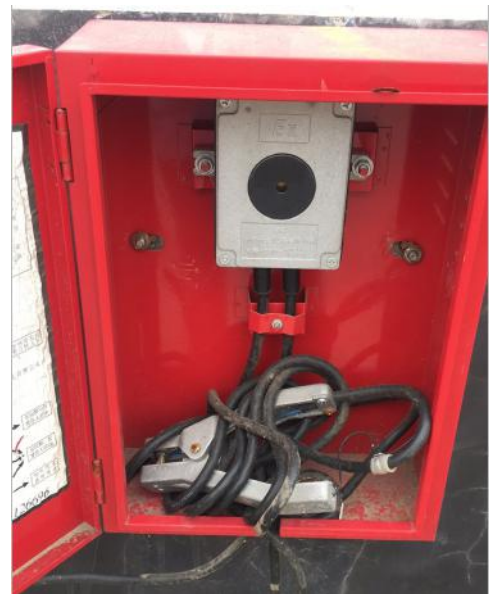
泄漏警报设施
