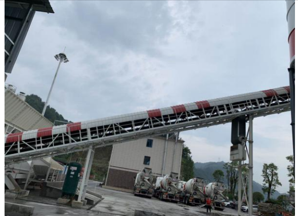
封闭式运输皮带
